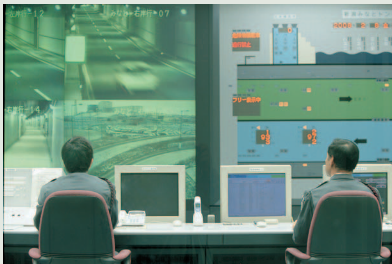
入船みなとタワー内にある沈埋トンネルの監視室。
